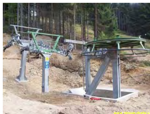
Talstation mit dem Abspannbock
