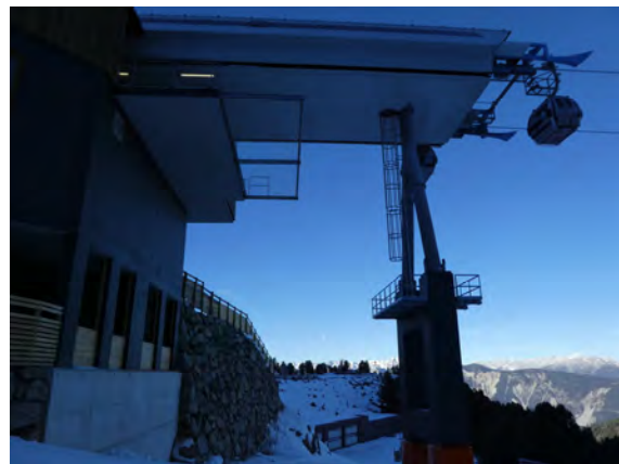
Bergstation Unterflurantrieb aufgeständert
