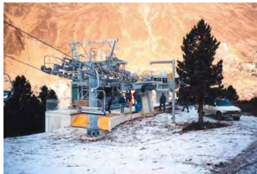
Gespannter Antrieb mit Förderbandeinstieg
