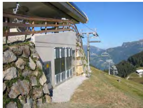
Bergstation Trafos mit Brandschutzklappen
