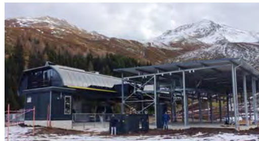
Containertrafo in der Talstation
