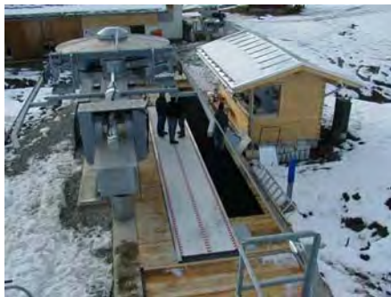
Talstation mit dem Förderband
